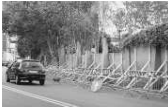
Il muro è stato temporaneamente messo in sicurezza
